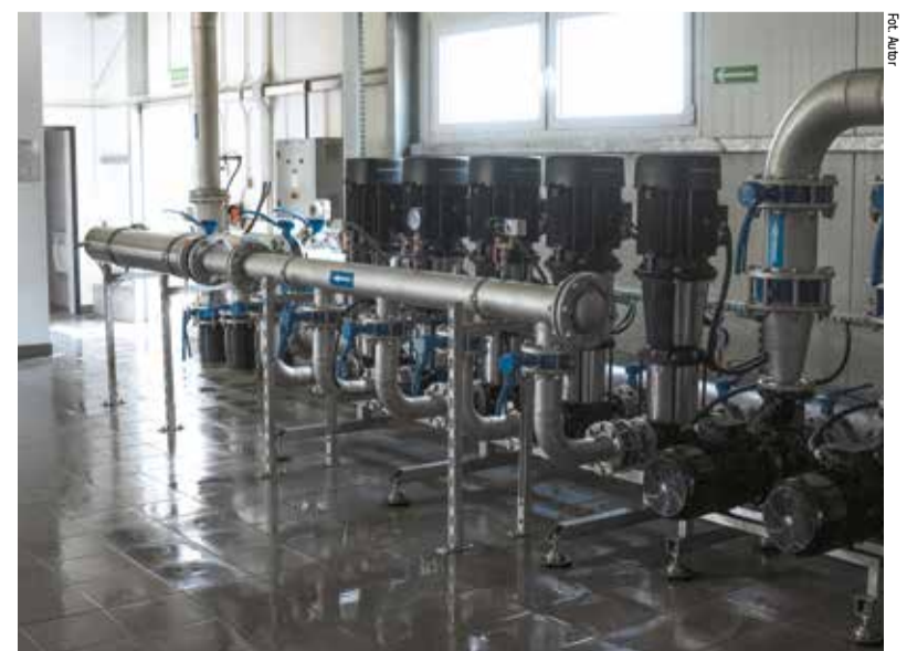
AA Stacja uzdatniania wody w Woli Będowej
