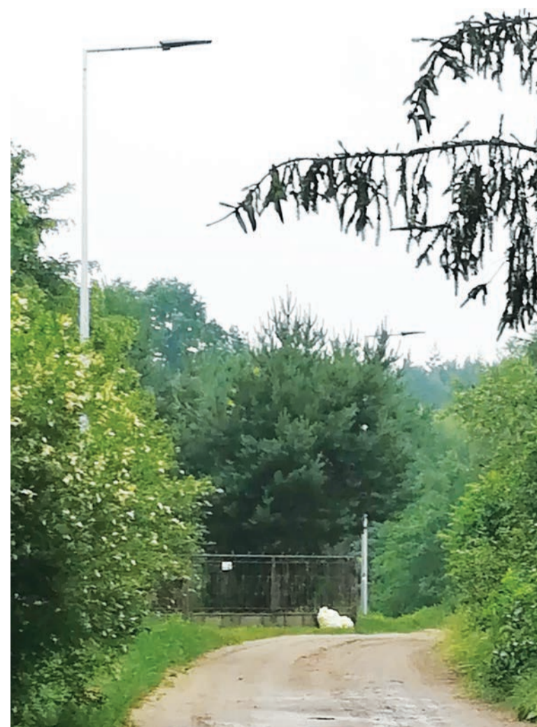
Nowoczesne oświetlenie stanęło także przy drogach gruntowych
