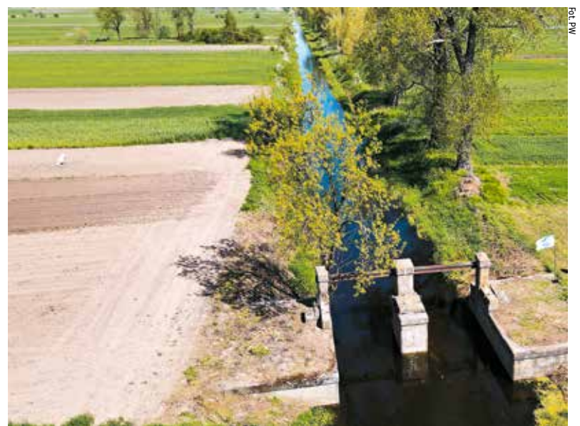
Jaz w miejscowości Złaków Borowy nie był remontowany od 1945 roku
