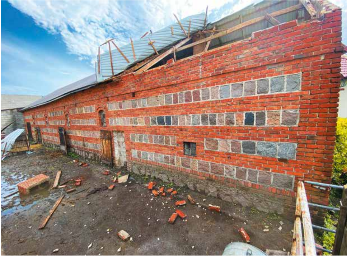
Zniszczony dach na budynku gospodarczym i kawałki blachy z oddalonego o 400 metrów domu ludowego wbite w ziemię
