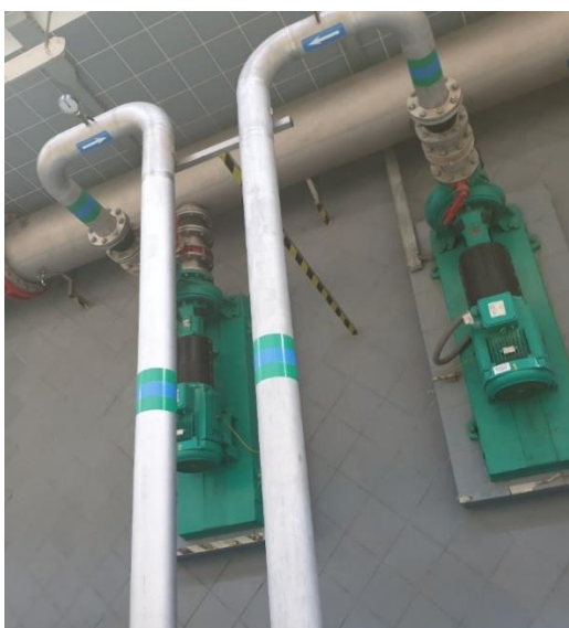
Rysunek 16 Pompy tłoczące uzdatnioną wodę do sieci magistrali MPWiK w Sieradzu
